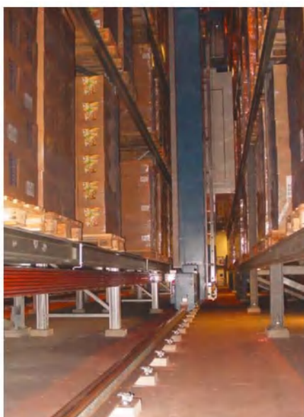
排式滑线在冷库供电和信号传输案例
